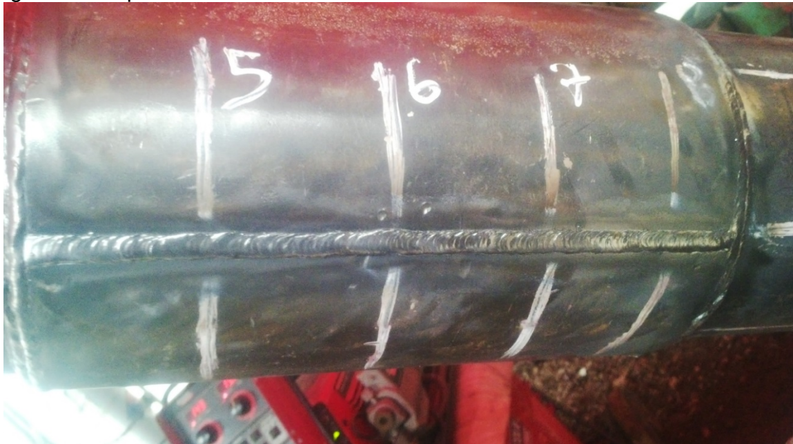
Figura 30. Inspección Visual Junta Ranura
