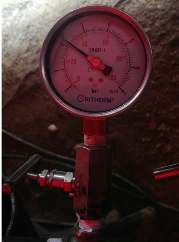
Figura 24. Verificación de Manómetro – Presión de Servicio
