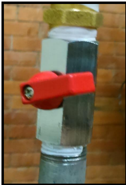
Ilustración 4 Válvula de paso de material
