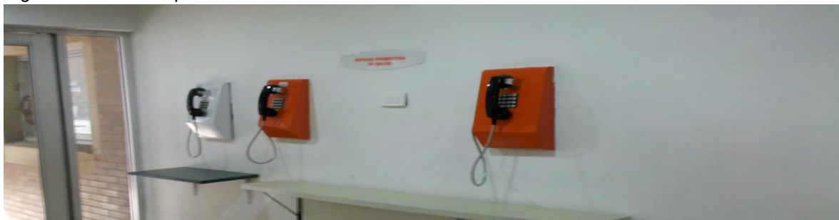
Figura 24. Teléfono para OYS.
