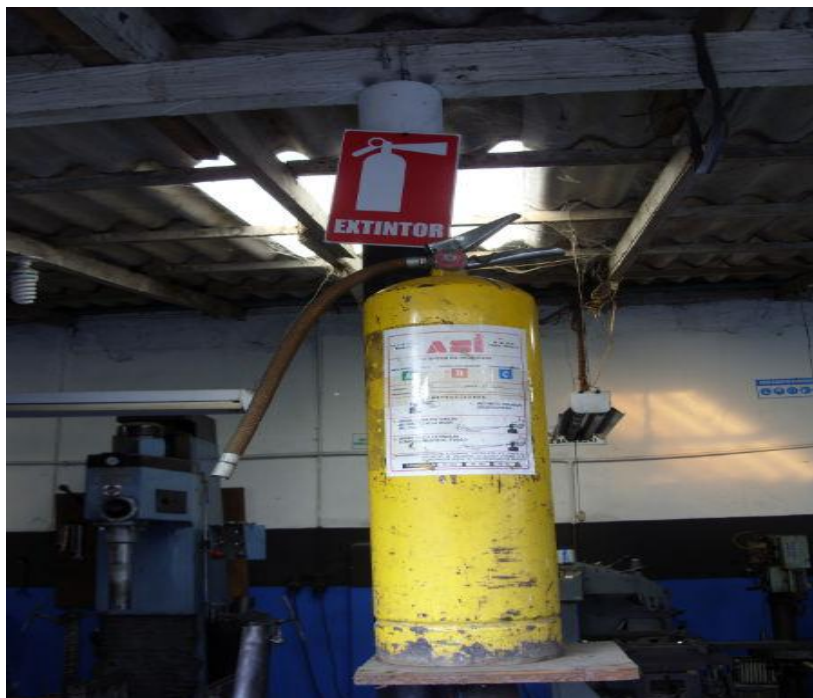
Figura 11. Ubicación de extintores
