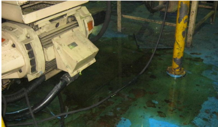
Figura 28. Suciedad en el piso del área de inyección preformas.
