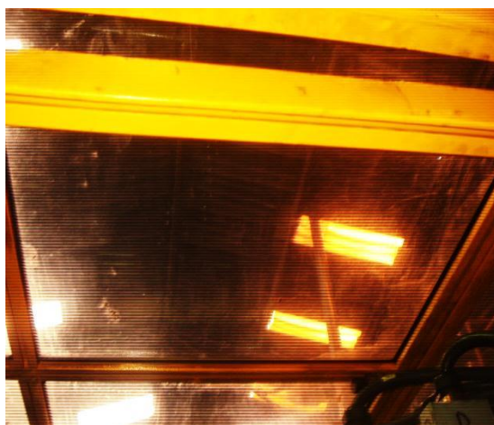
Figura 53. Vidrio del techo de una inyectora después de la limpieza.
