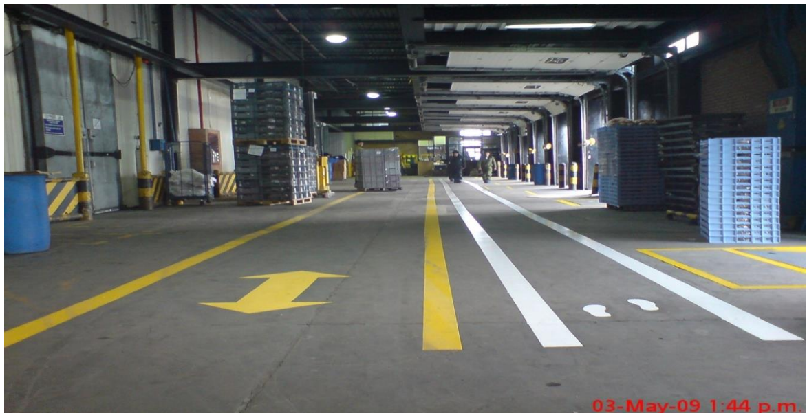
Figura 27. Foto muelle de recibo demarcado
