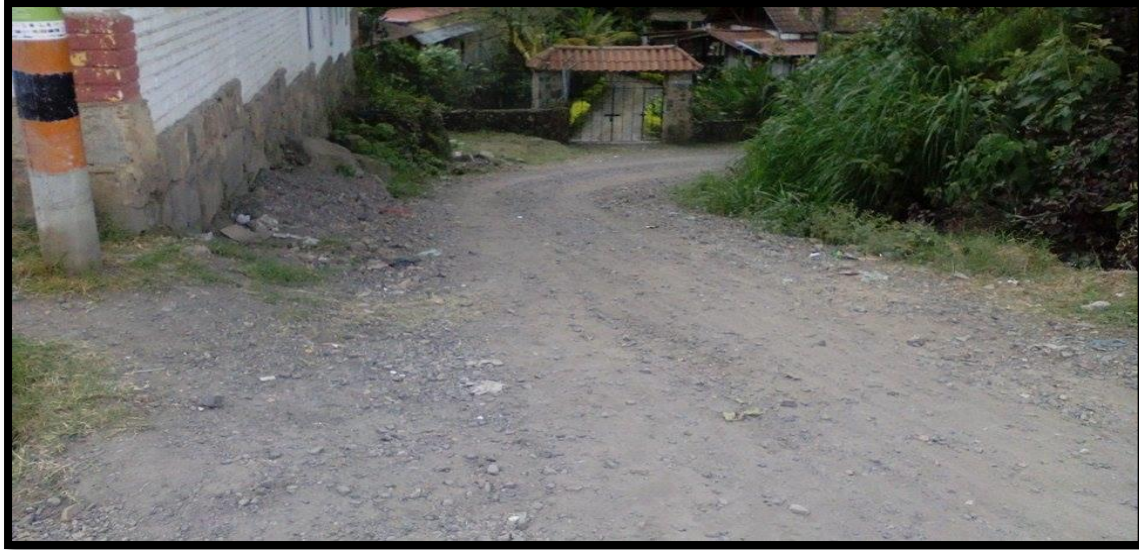
Fotografía 7 Zona de deslizamiento, ubicada en la calle 3 N. 10 - 2
