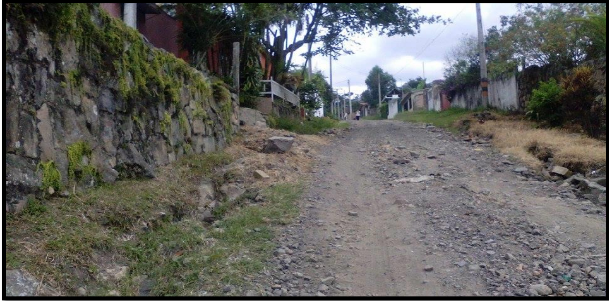
Fotografía 5 Zona de deslizamiento, ubicada en la carrera 8.
