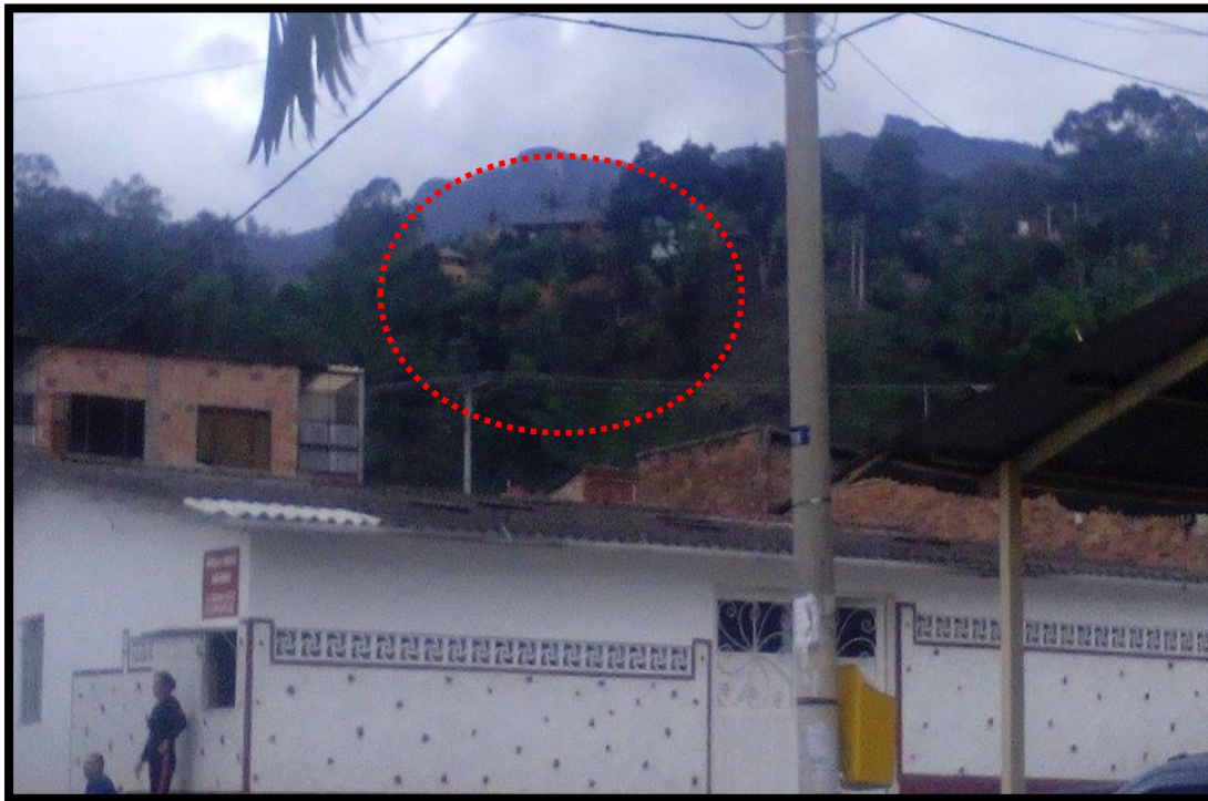
Fotografía 1 Tomada desde la Carrera 3era, zona donde se presenta amenaza en remoción de masa.
