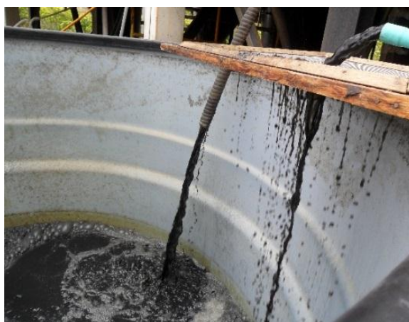
Figura 11. Tanque de homogenización con recirculación para mezclado de corrientes con aguas contaminadas a tratar.
