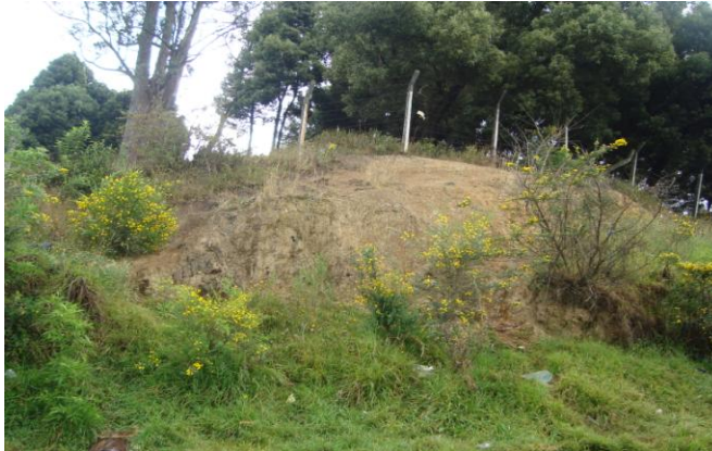
Figura 4. Panorama de una zona en proceso de erosión
