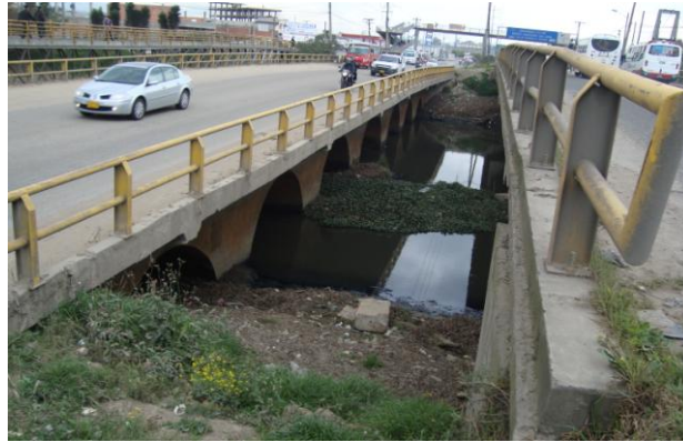
Figura 40. Estructura de encausamiento de puente y vía
