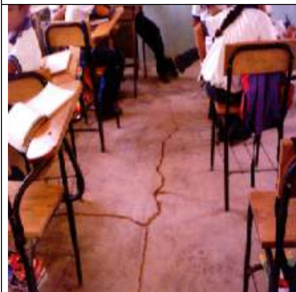
La misma aula de clase, en la imagen se observan los estudiantes asistiendo a clases ignorando el riesgo que corren, tambien se aprecia el asentamiento diferencial que ocurre en el piso y en general en toda el aula.
