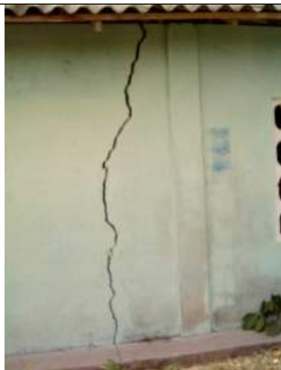
Otra imagen donde se aprecia la gravedad del aula de clase que debe ser demolida para evitar posible accidente que afecte a los estudiantes
