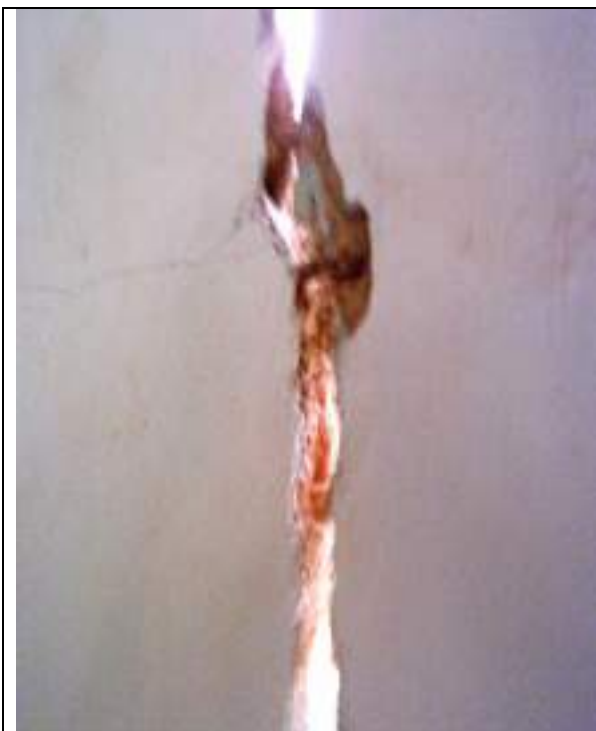
Esta imagen muestra la intensidad de las grietas, muestra además el acero colocado para coserla, pero este no fue suficiente.
