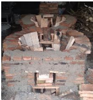
Gambar 4. Pembuatan Ruang Bakar Kedua dan Pemasangan Batu Bata Biasa Untuk Membuat Celah sebagai Isolator Rugi Panas Dengan Batu Bata Tahan Api SK32
