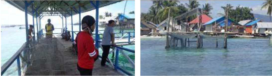
Gambar 6. Kondisi infrastruktur dermaga Sumber: Analisis Penulis, 2017
