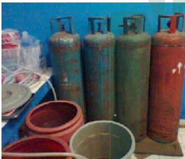
Gudang penyimpanan gas elpiji
