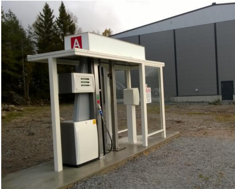
Kuva 4.1. Paineistetun biokaasun tankkaukseen soveltuva tankkausasema Jepuan biokaasulaitoksella. (kuva: Jepuan biokaasulaitos)
