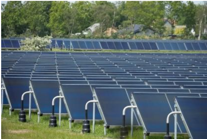
Kuva 6.3. Løgumklosterissa Tanskassa on yli 10 MW tai 15 000 neliötä suomalaisia aurinkolämpökeräimiä. (GSTEC Global Solar Thermal Energy Council, 2015) Kuva: Savo-Solar Oyj.
