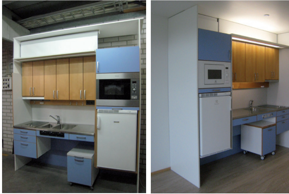
Kuva 16. Oikean puoleisessa kuvassa on korkeussäädettävä pienoiskeittiö C, jossa työtaso laatikostoiheen on säädettävissä 200 mm ja yläkaapisto 400 mm. Korkean kaapin säädön on oltava vähintään 400 mm, jotta mikroaaltouuni tulee riittävän alas. Vasemman puoleisessa kuvassa on testitilaan toteutettu mallikeittiö ja oikean puoleisessa kuvassa on peilikuvana toteutettu pilotointikohteen keittiö.
