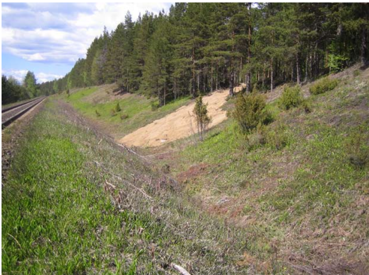
Kuva 8. Vesijohdon kaivutyön jälkiä Kuoringassa.
