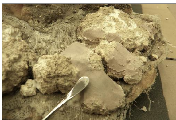
Slika 27. Veća oštećenja u žbuci zapunjena su laganom nadoknadnom žbukom koju čine VAPO 0/1 i punilo od recikliranog stakla.
