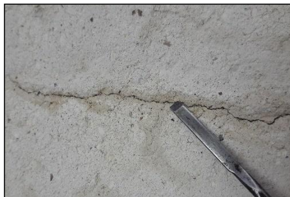
Slika 136. Ljevkaasto proširena pukotina pripremljena za zapunjavanje nadoknadnom žbukom.
