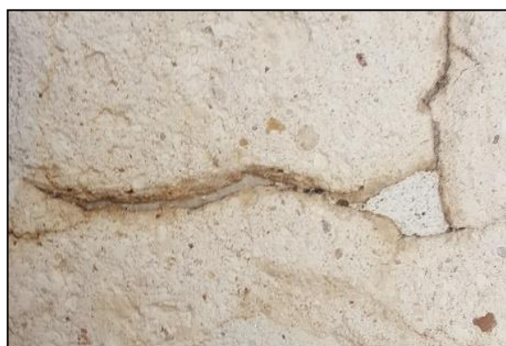
Slika 134. Jedna od pukotina u sloju intonaa koja seže sve do vidljive poleđine facinga .
