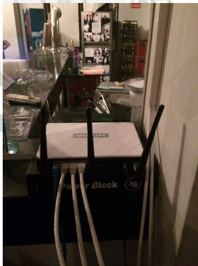
Figura 26. AP instalado para la mezcladora
