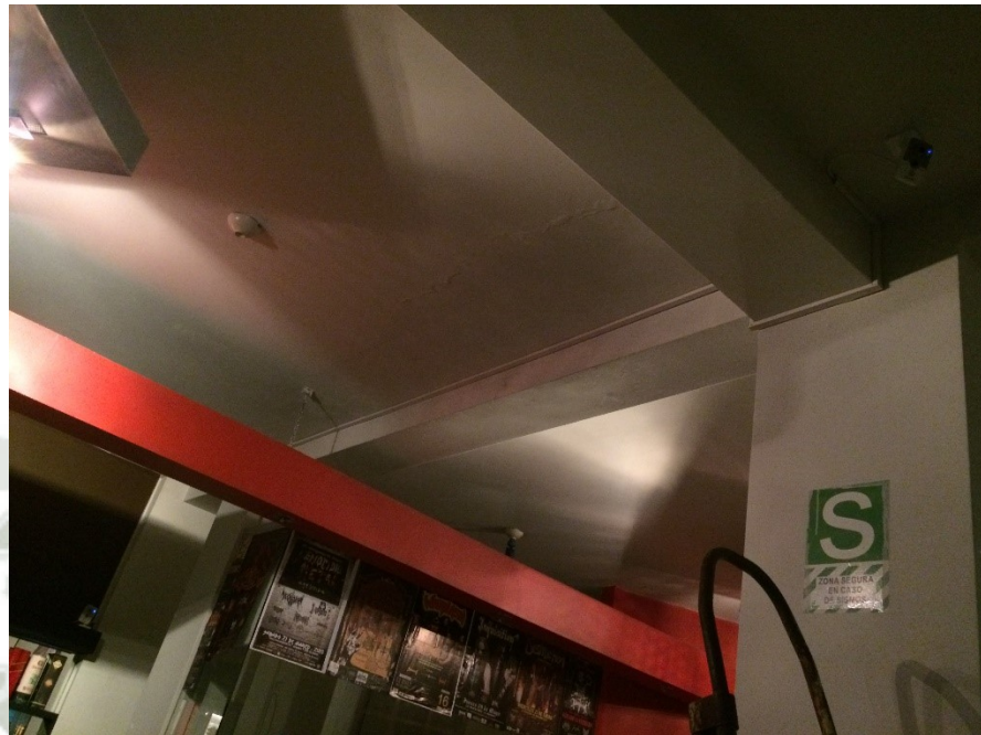
Figura 25. Cámaras instaladas en el local
