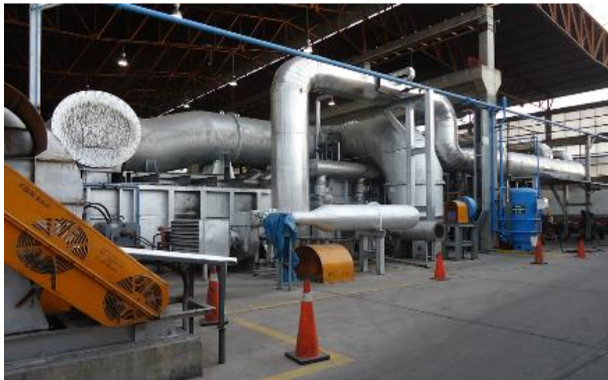
Fotografía 8 : Horno de recalentamiento Bendotti Fuente: Elaboracion propia
