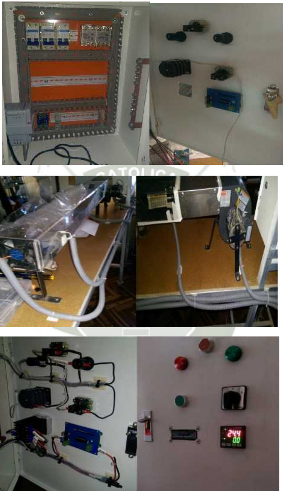
Figura 3.34: Montaje de componentes y accesorios. Fuente: Fotografía
