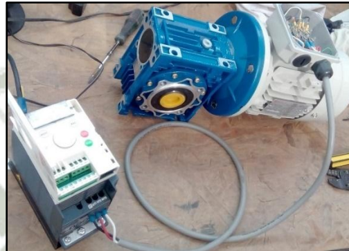
FIGURA 133: Prueba de conexión entre ATV 12 y Motorreductor Trifásico.
