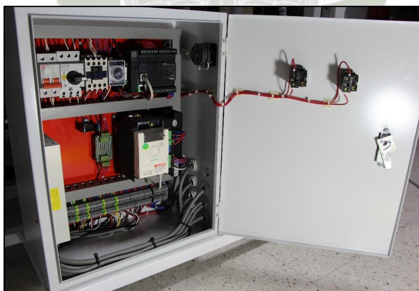
FIGURA 146: Tablero eléctrico del proyecto
