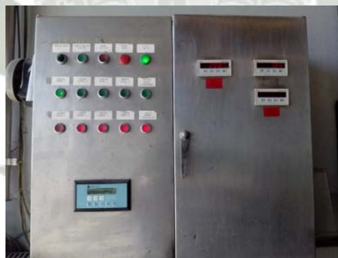
Figura 29: Tablero de control del sistema de Alimentación de Agua hacia Calderas
