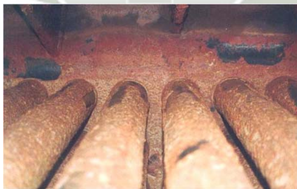
Figura 2: Incrustaciones en tubos de humo
