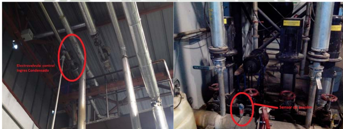
Figura 56: Sistema de Alimentación de Agua hacia Calderas de Agroindustrial del Perú, para la recolección de datos
