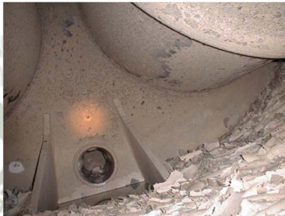
Figura 3: Acumulación incrustaciones en fondo cuerpo presión caldera
