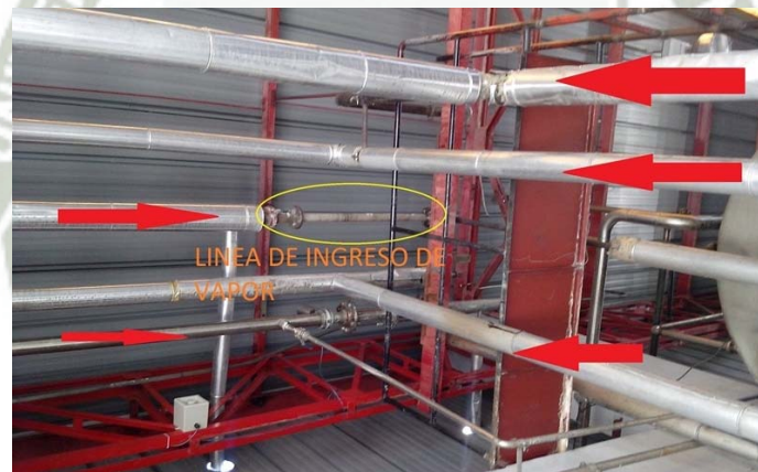
Figura 31: Tubería de Ingreso Vapor Tanque Desaerador
