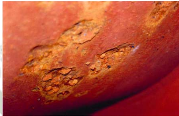
Figura 5: Corrosión caustica en fogón de una caldera
