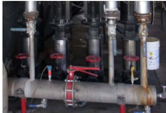
Figura 108: Bombas de Alimentación de Condensado a Calderas del Proyecto
