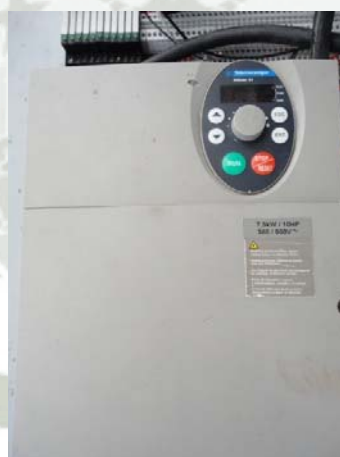
Figura 48: Variador de Velocidad 7.5KW Telemecanique
