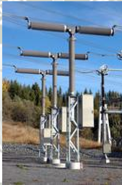
Figura 8.- Interruptores de potencia
