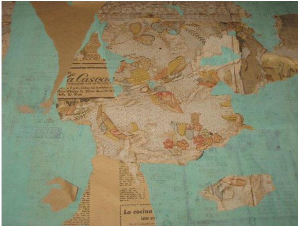
Figura 41.- Estado actual de las telas que servían como parte de las divisiones de los cuartos.
