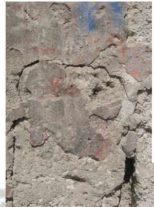
Figura 36: Pérdida de tarrajeo de muros exteriores y capas de pintura.
