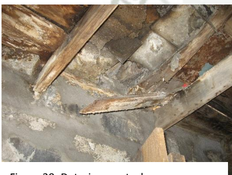
Figura 39: Deterioro en techos.
