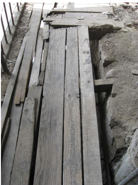
Figura 37: Deterioro de entablamento de pasadizo.
