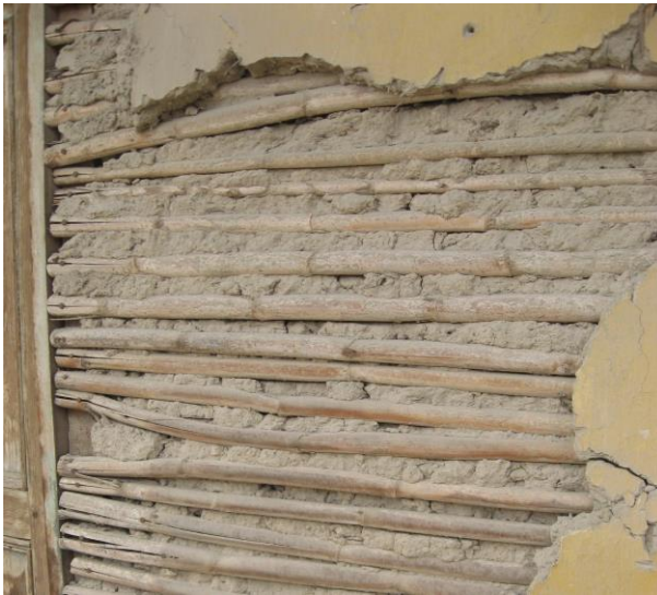
Figura 33: Degradación del tarrajeo que cubre los muros de quincha de la habitación superior.
