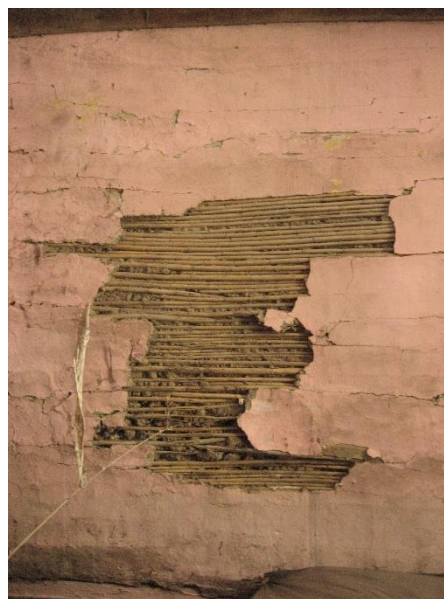
Figura 38: Perdida de tarrajeo en muro de quincha.
