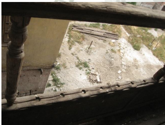
Figura 43.- Laguna en los balaustres del corredor exterior y desgaste de madera por lluvias y exposición al sol.
