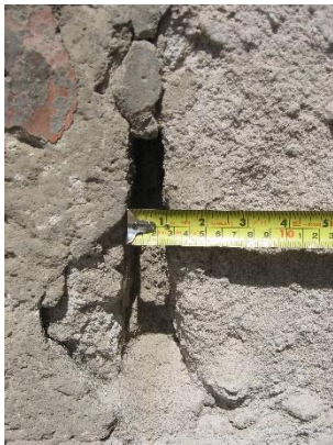
Figura 35: Pérdida de argamasa entre bloques de sillar.
