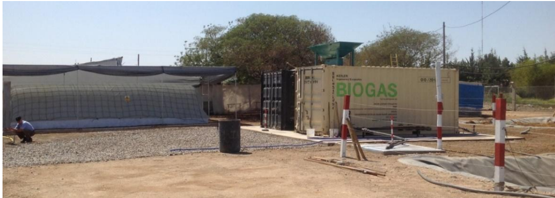
Figura 16. Planta experimental HPTC-RM instalada en el fundo de Majes de la UCSM.
