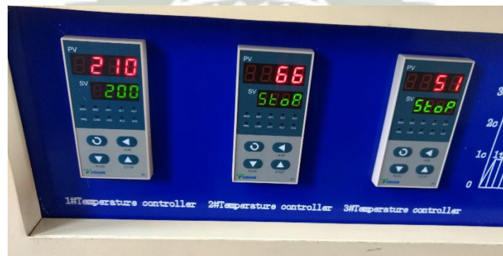
Figura 25: Panel de Controladores Yudian AI708P Fuente: Elaboración Propia
