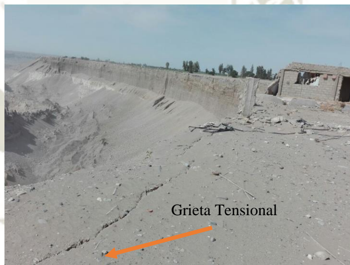
FIGURA 5.23. Foto de grietas tensionales en el borde del talud.
