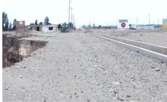
FIGURA 5.12. Tramo del canal de Irrigación en el sector 2, ubicado a 6 metros de la escarpa principal.
