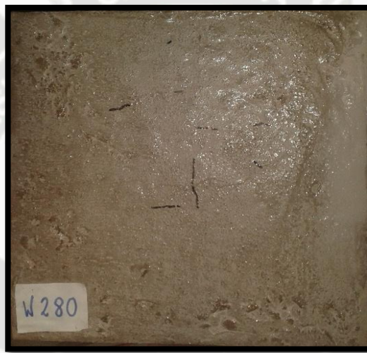
FIGURA 2.10 Fisuras típicas por retracción plástica
