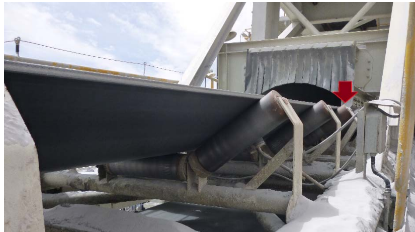
Figura 3.1.9: Fotografía Cola de Faja – Ubicación de Celda de Carga a Primer Polín de La Salida del Encausador.
