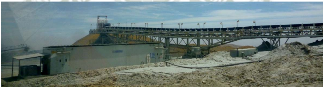
Figura 3.1.18: Fotografía de La Sala Eléctrica ER; Próximo a La Faja Transportadora. Fuente:[Elaboración Propia ]
