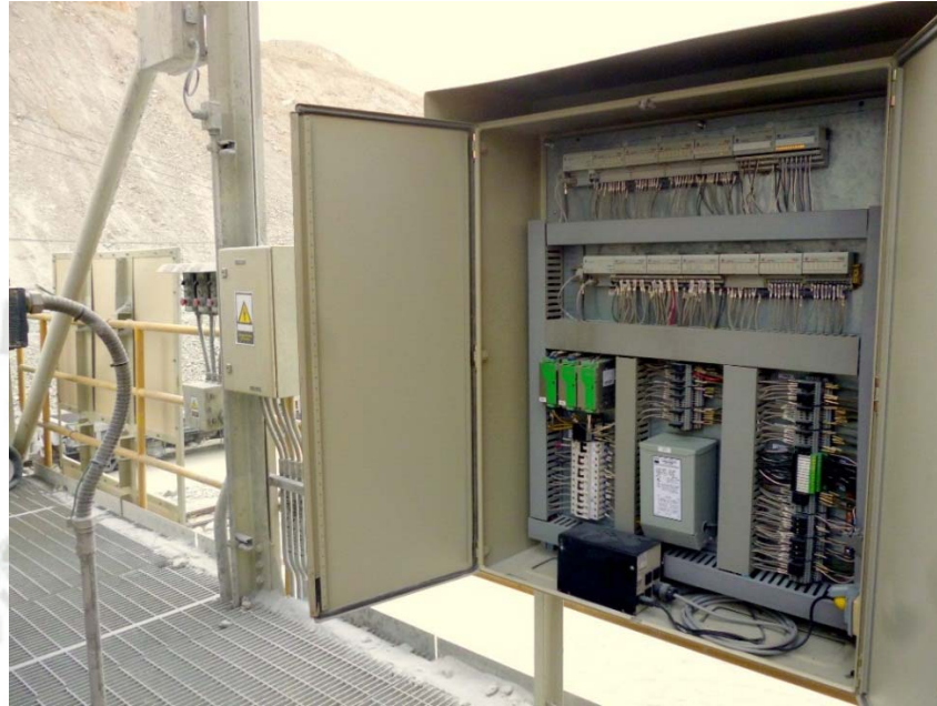
Figura 3.1.19: Fotografía del Tablero Eléctrico a Máxima Capacidad de Módulos y Equipos FLEX I/O
