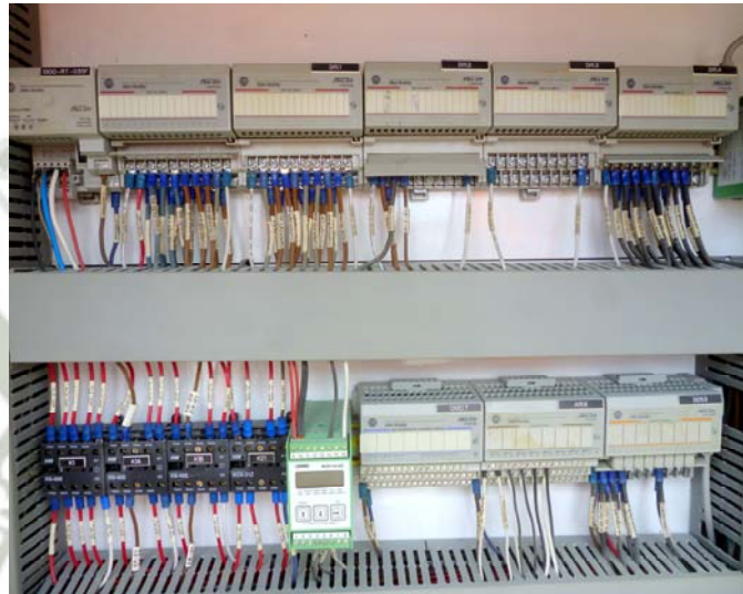
Figura 3.1.20: Fotografía del Tablero Eléctrico a Capacidad Media con Módulos FLEX I/O.
