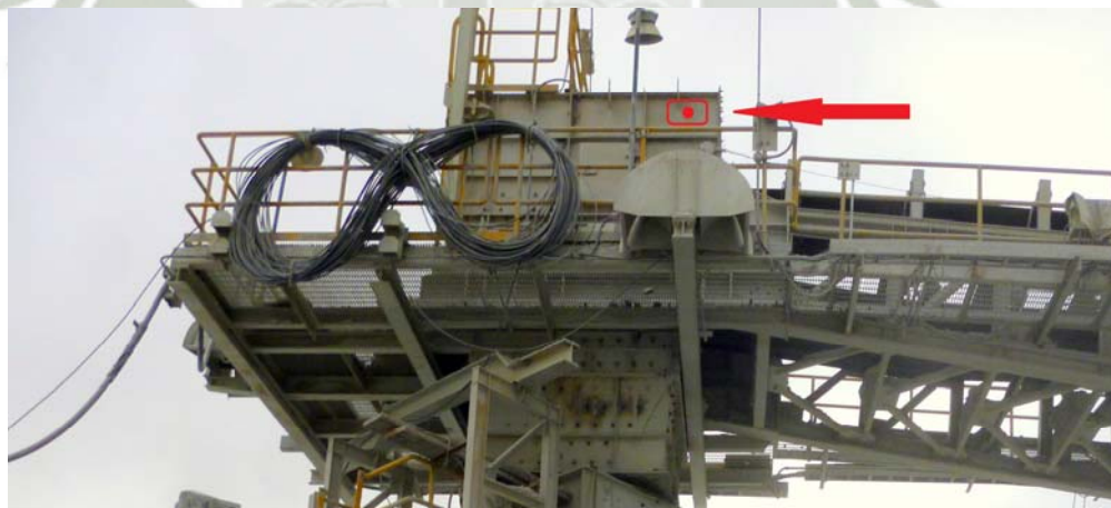
Figura 3.1.13: Fotografía Cabeza de Faja – Ubicación del Transmisor por Vibración.
