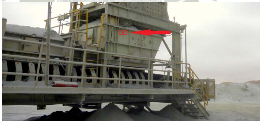
Figura 3.1.14: Fotografía Cola de Faja – Ubicación del Transmisor por Vibración.
