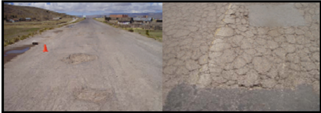
FOTO 5. 1. Se aprecia falla piel de cocodrilo en el pavimento, estas fallas requiere inmediata Rehabilitación
