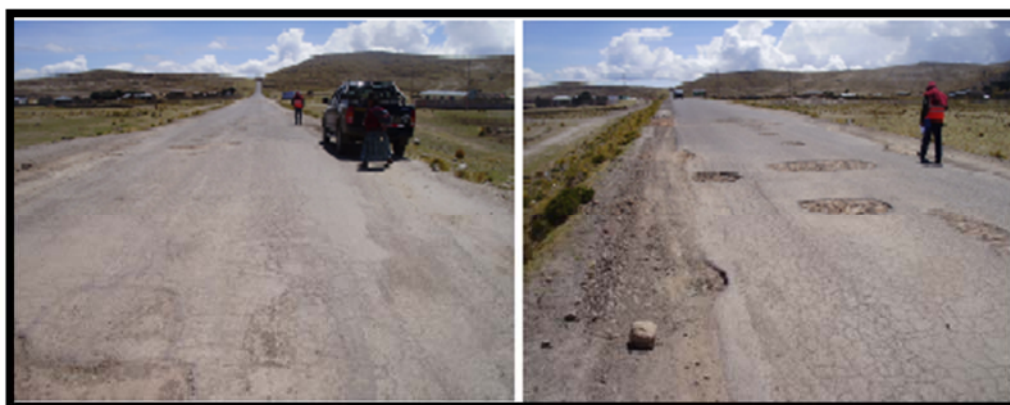
FOTO 3. 2. Forma de pampa por donde se emplaza la carretera, con presencia de fallas estructurales en el pavimento.
