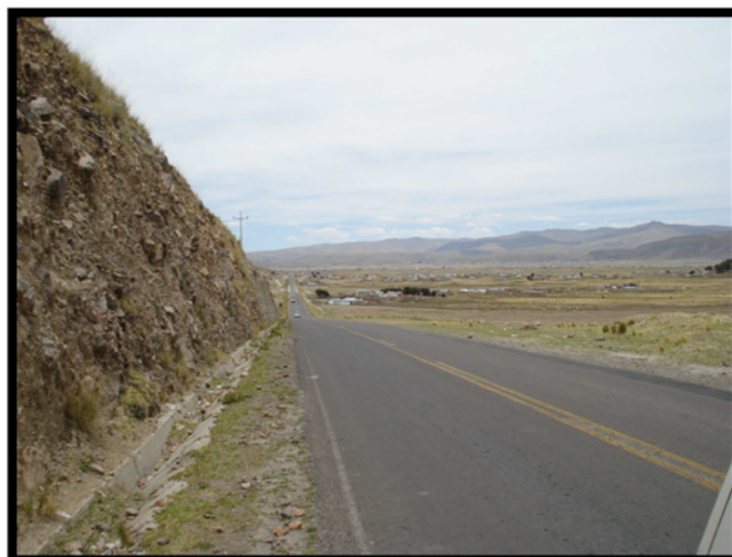
FOTO 5. 2 Cunetas colmatadas con sedimentos y piedras por falta de mantenimiento prog. Km. 8+100 a 8+300 del tramo de la vía Chacachaca - Yunguyo.
