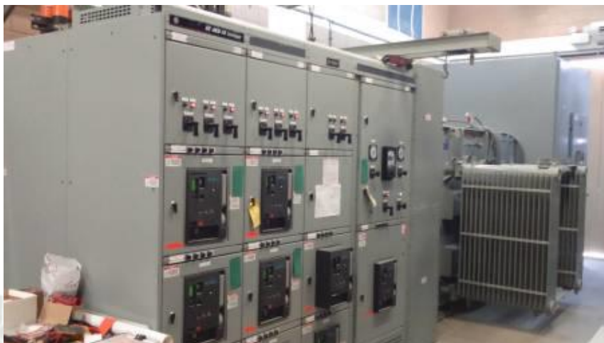
Imagen "12": Interior Sala Eléctrica Principal (Creación Propia).
