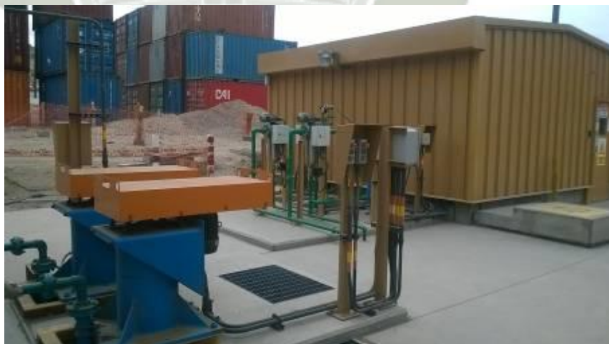
Imagen “7”: Sala Eléctrica de Lavadero de Unidades (Creación Propia).
