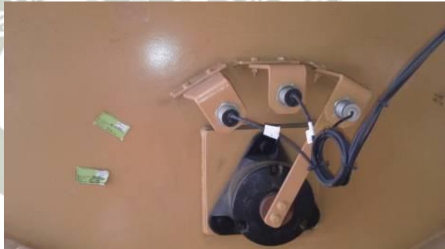
Imagen "32": Interruptor de Posición en Chute Pantalón (Creación Propia).
