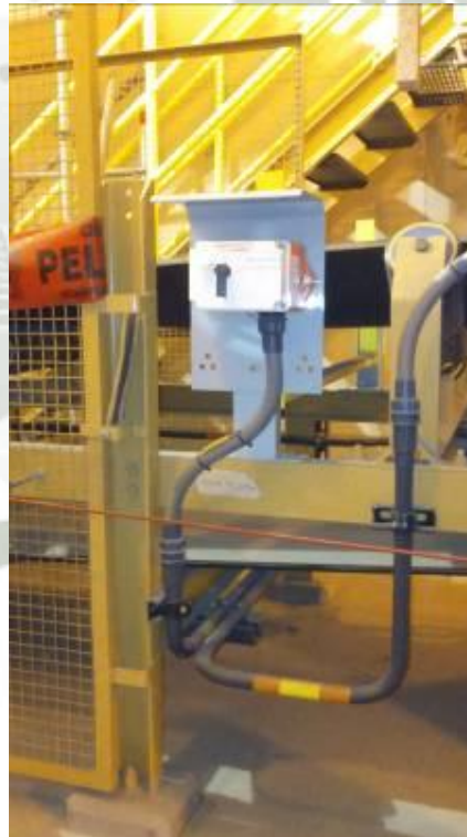
Imagen “26”: Des-alineamiento en Belt Conveyor (Creación Propia).
