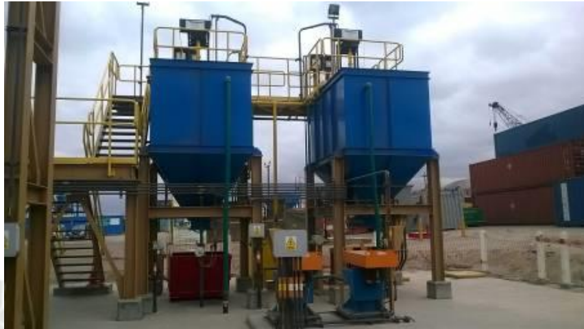
Imagen "8": Tanques Sedimentadores en Lavadero de Unidades (Creación Propia).
