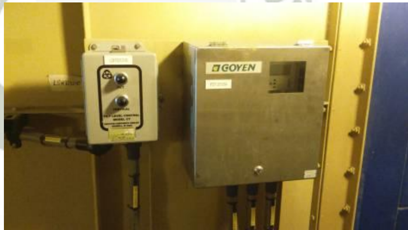
Imagen “31”: Transmisor DP en Belt Feeder (Creación Propia).
