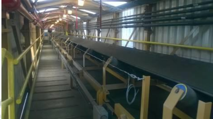
Imagen “40”: Rociadores (Creación Propia).
