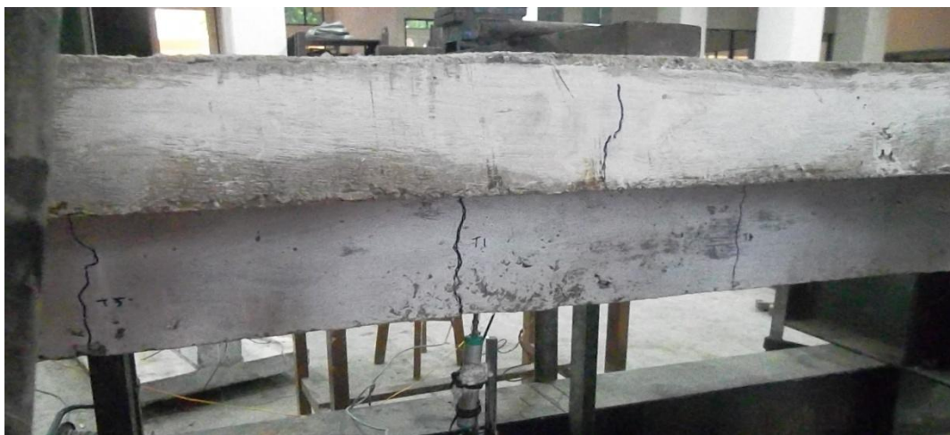
Gambar 4.40 Pola Retak Balok Tanpa Sambungan (BTS)-A
