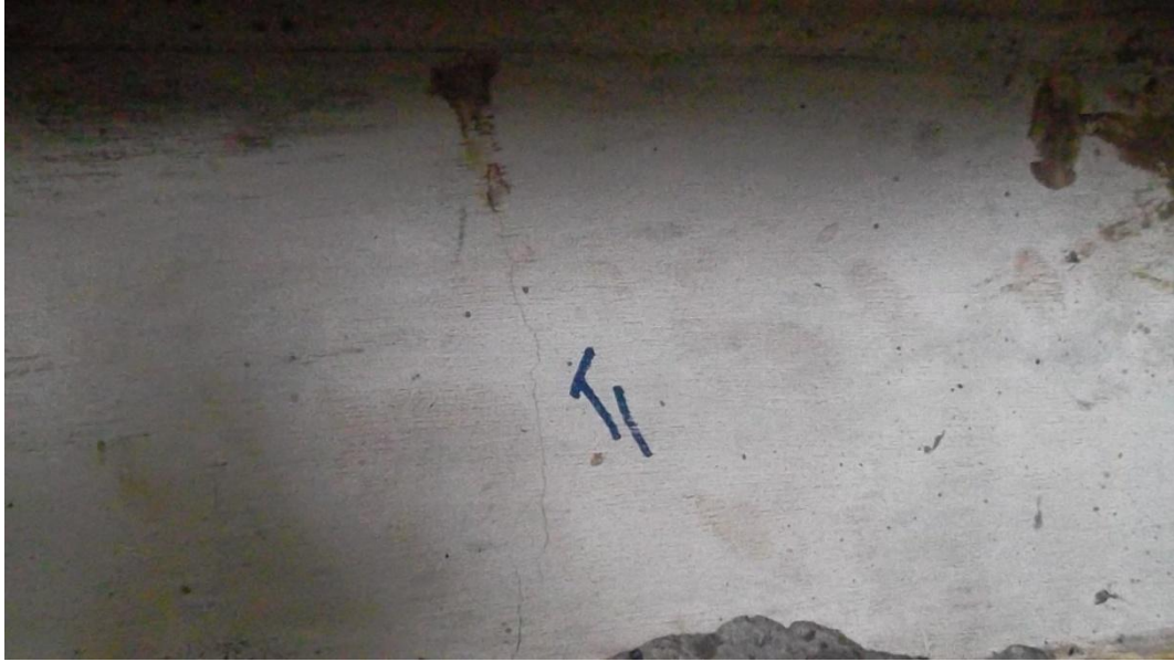
Gambar 4.42 Pola retak balok tanpa sambungan (BTS)-C
