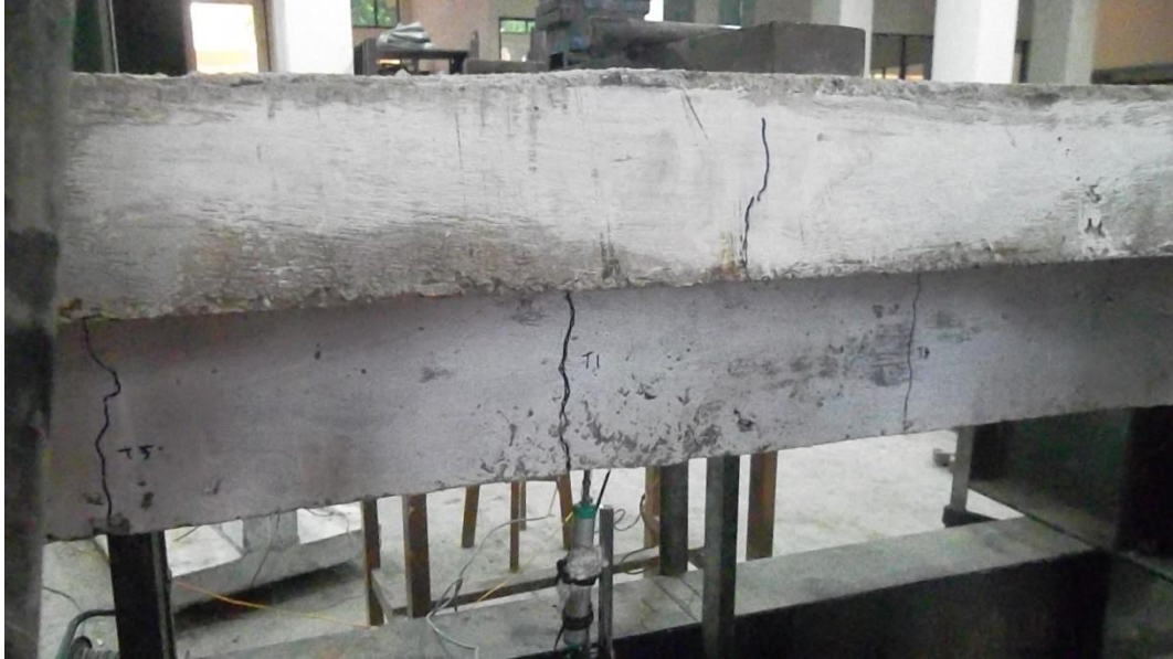
Gambar 4.3 Retak Yang Terjadi Pada Balok T Tanpa Sambungan A ( BTS-A )
