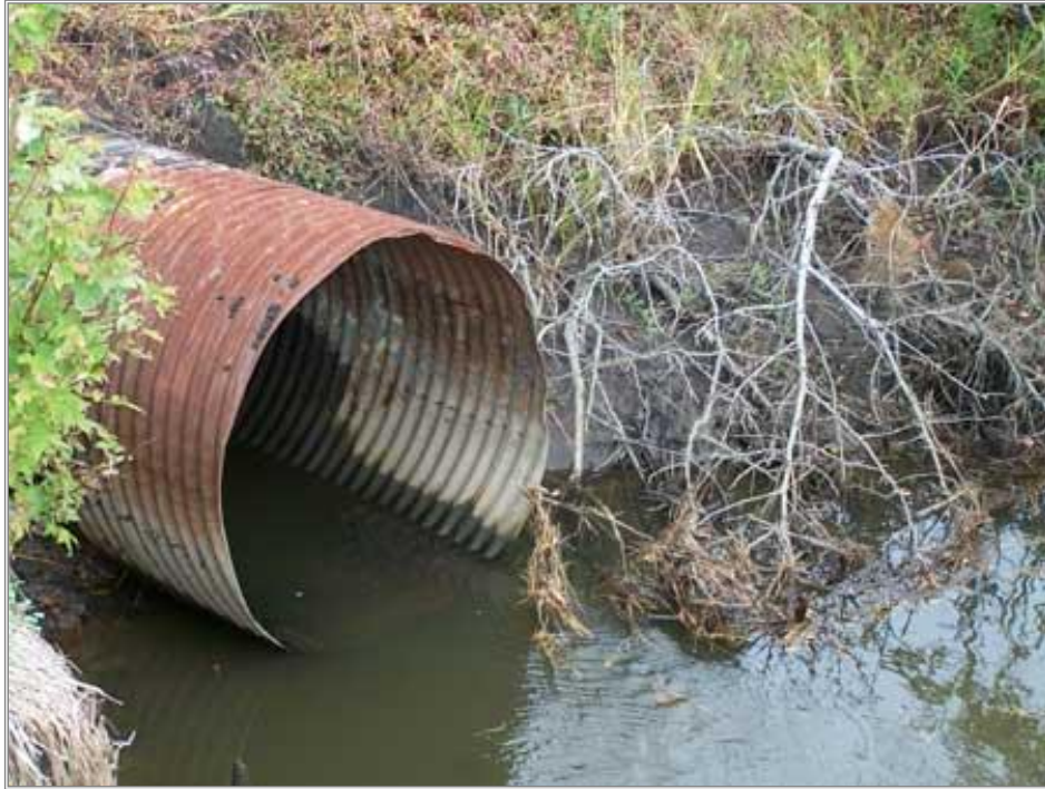
Slika 1. Prikaz neadekvatnih objekata za odvodnju otpadnih voda
