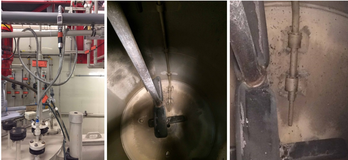
Abbildung 8-9: Versuchseinrichtung der Lufterdüsung während dem FLUWA-Betrieb der KVA Linth.
