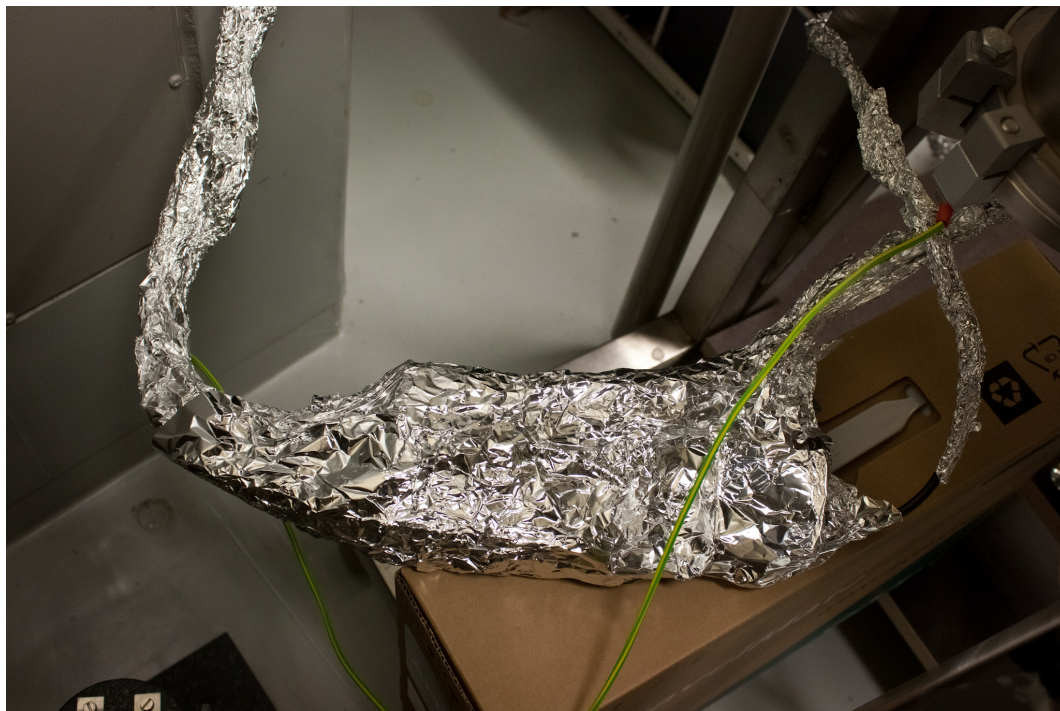
Kuva 43. Alumiinifoliolla päällystetty esivahvistin.
