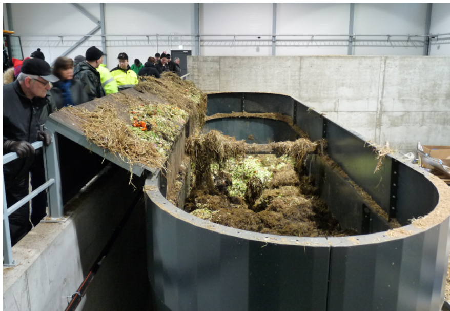
Kuva 26. Jepuan biokaasulaitoksen kiinteän raaka-aineen syöttösiilo.
