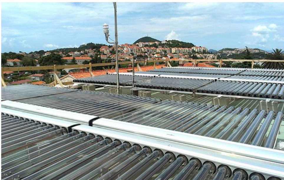
Slika 9. Polje solarnih vakuumskih kolektora na krovu objekta [16]
