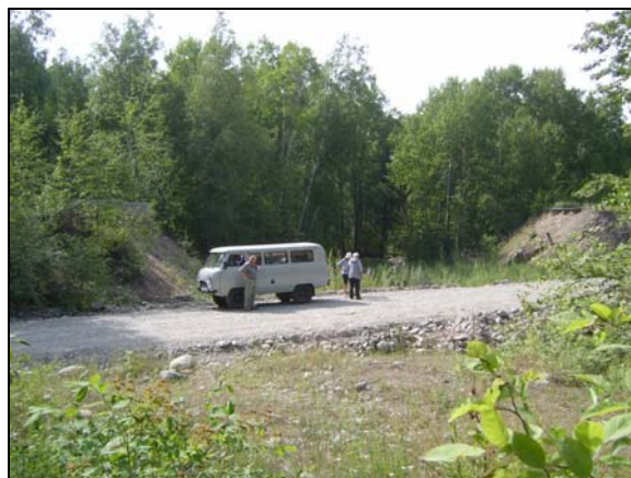
Fot. 7. Zniszczony przez siel most na potoku Duszkaczan (fot. A. A. Rybczenko) Phot. 7. Bridge on the Dushkachan stream, damaged by sel (mur) (phot. by A. A. Rybczenko)
