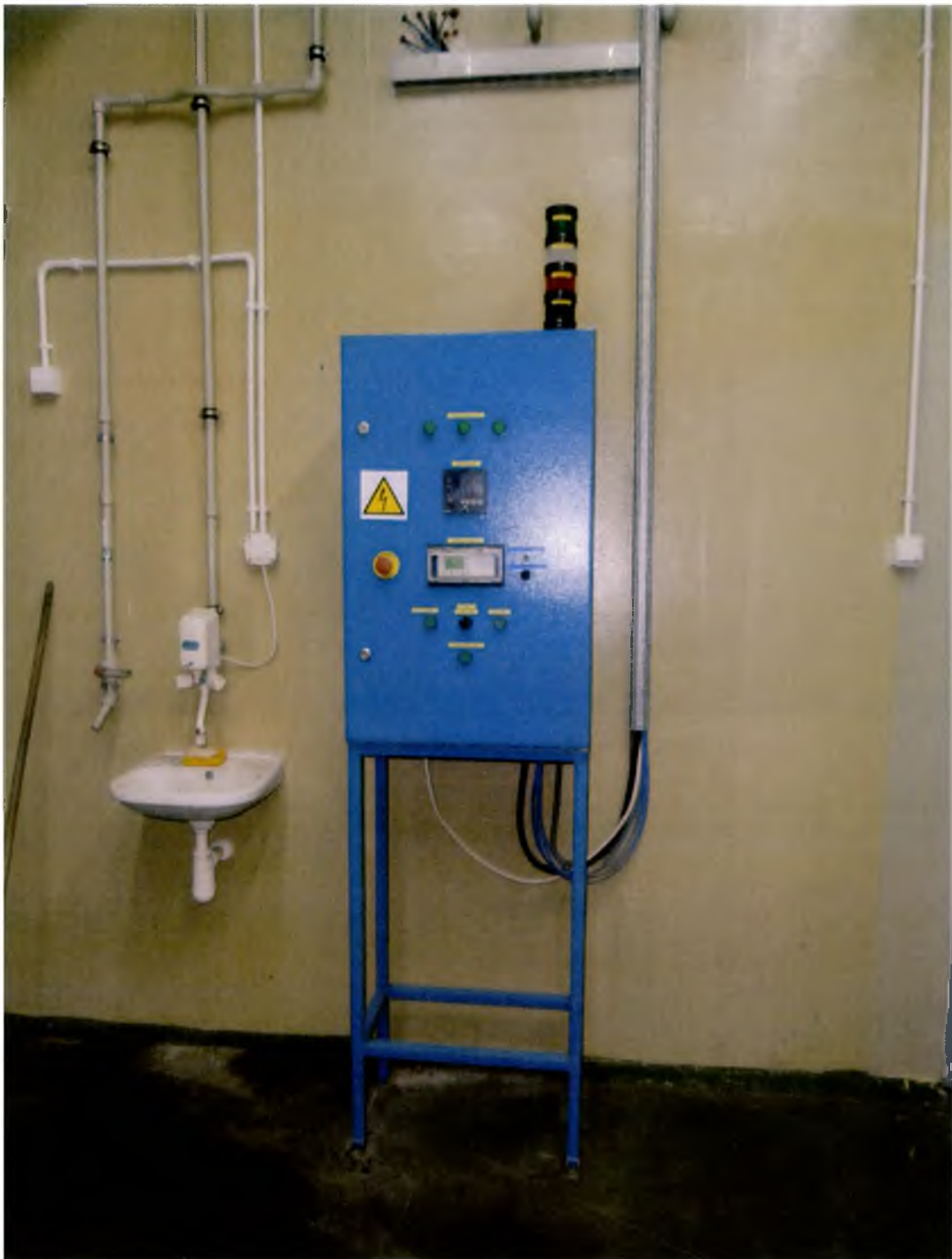
Rys. 29. Szafa sterownicza pieca wodorowego.
