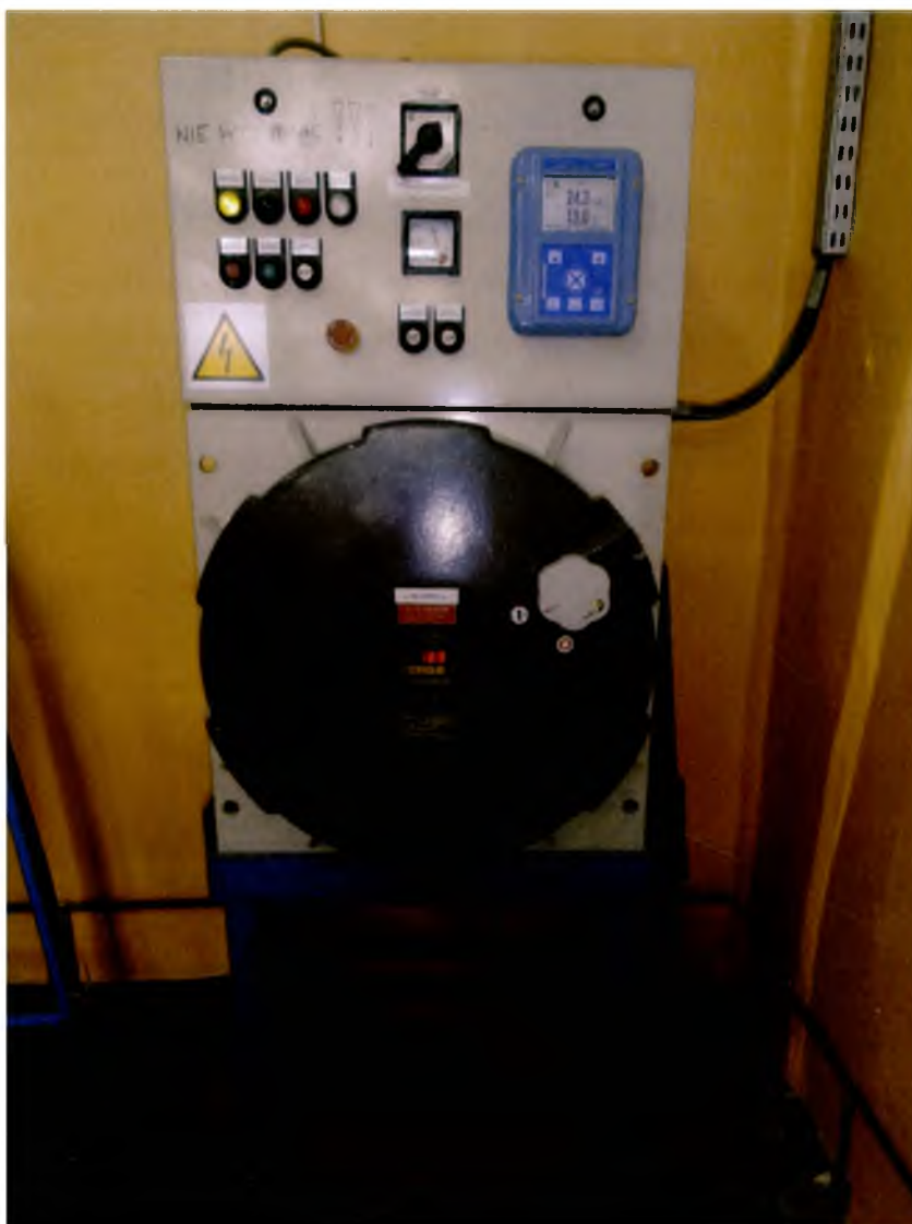
Rys. 24. Szafa sterownicza wirówki szybkoobrotowej.
