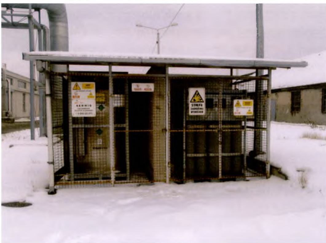
Rys. 31. Stacja gazów (po lewej zbiornik z azotem, po prawej wiązka butli z wodorem).
