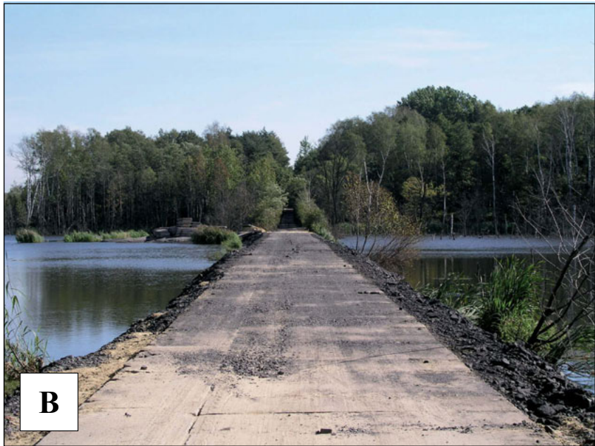
Fot. 5. Stan drogi przed modernizacją w kwietniu 2004 r. (A) i po jej remoncie we wrześniu 2004 r. (B) w Zabrze-Makoszowach (fot. R. MACHOWSKI, 2004)
