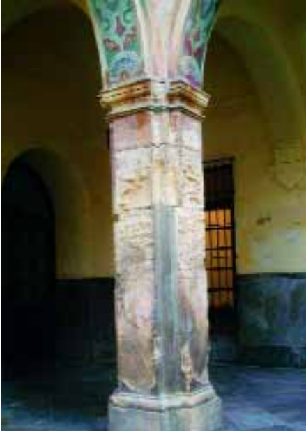
Daño que producen las intervenciones realizadas con mortero de cemento (Hospital de San Juan de Dios, Granada). Foto: Ana Luque
