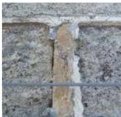
fig 2. Frente de sales localizado en las llagas de la piedra del cuerpo superior del edificio.
