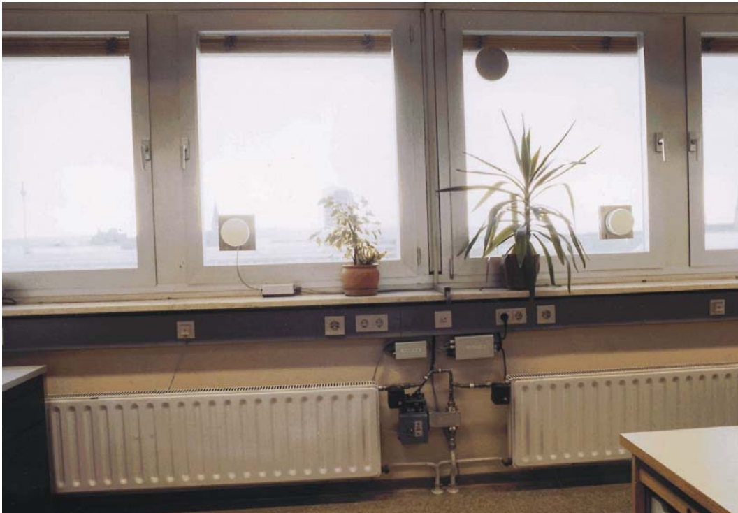
Abb. 4.2-1: Raum 1 des Test- und Demozentrums für Integrierte Haussysteme am IITB
