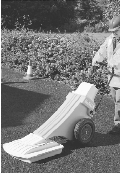
(a) Fahrbares System „Pipehawk“ von EMRAD, Ltd., Mittenfrequenz 500 MHz.
