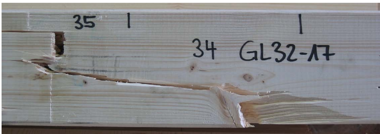
Bild A-92 GL32c-17: Holzversagen in der Randlamelle, Untersicht
