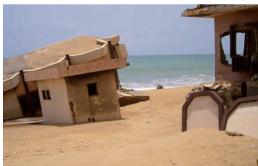
Foto 2: Küstenerosion bei Sèmè Photo 2: Erosion côtière à Sèmè
