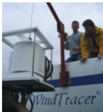
Montage des Messkopfes auf das Wind-Lidar, das in einem Container installiert ist.
