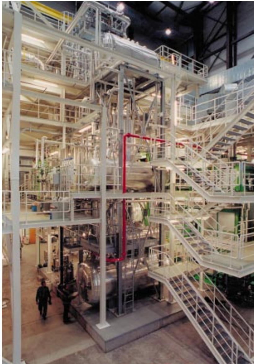
Abb. 5: THERESA – Ausschnitt der fertiggestellten Gesamtanlage (Februar 2000).
