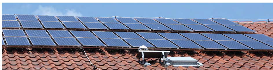
Die Solaranlage auf dem Dach des Elektrotechnischen Instituts (ETI) wird bereits erfolgreich mit den dort entwickelten Geräten zur Leistungsmaximierung betrieben.
