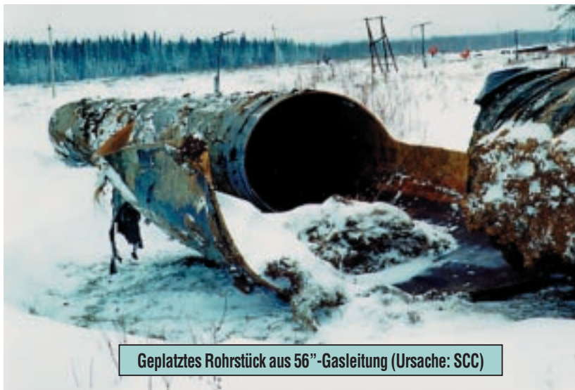
Abb. 1: Beispiel für einen Pipelineschaden, der durch Spannungsrisskorrosion verursacht wurde.
