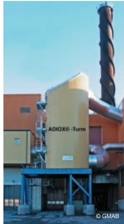
Abb. 7: Teilansicht der Rauchgasreinigung MVA Linköping,
