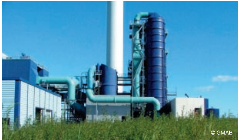
Abb. 4: Bild der Nasswäscher der MVA Holstebro.
